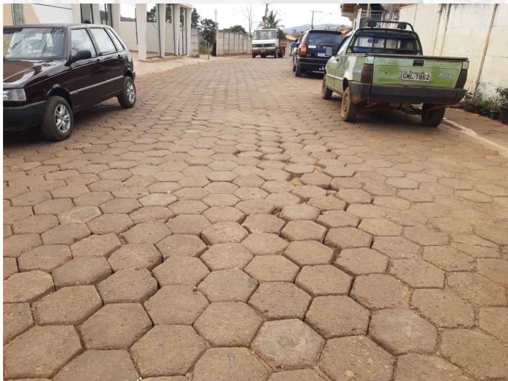
Figura 4 - Pavimento de rua a ser reconstruído
