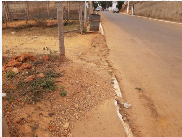
Figura 1 - Calçadas a serem reparadas
