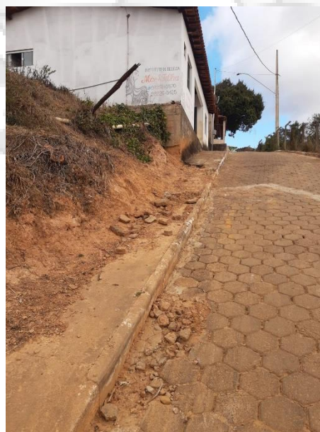
Figura 2 - Calçadas a serem reparadas
