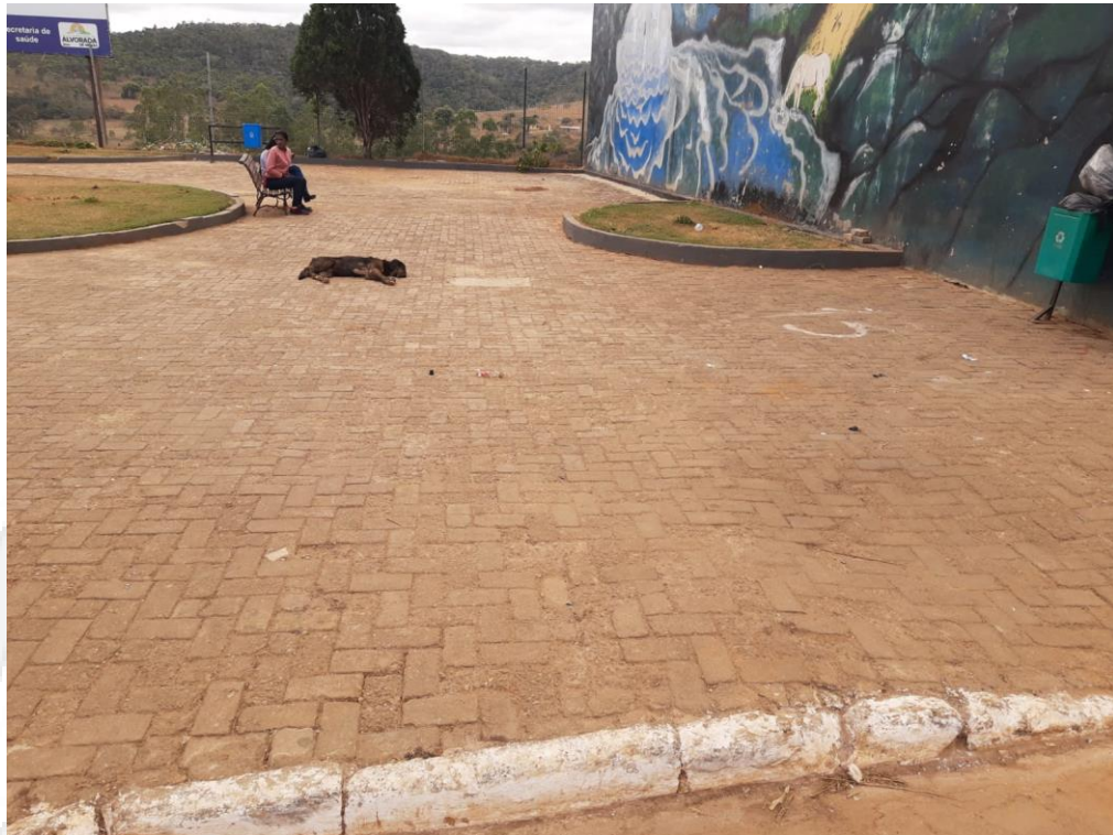
Figura 3 - Pavimento de Praça a ser reconstruído
