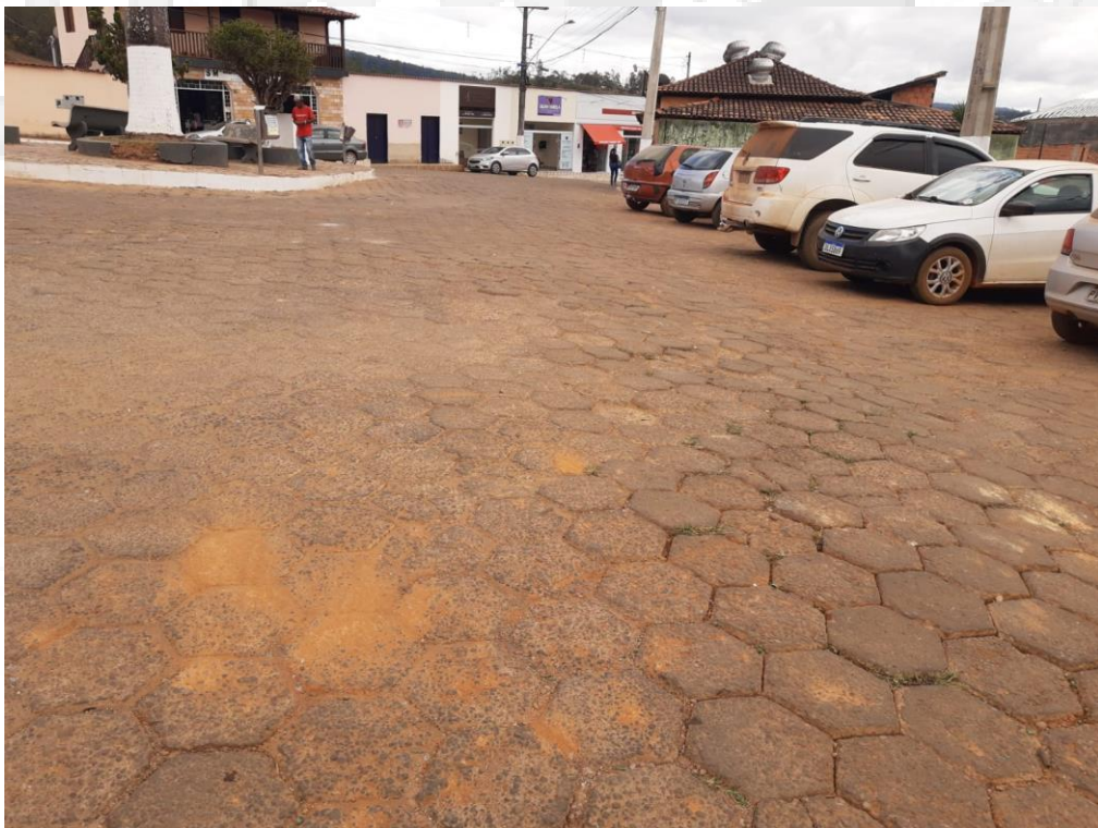
Figura 6 - pavimento de rua a ser reconstruído
