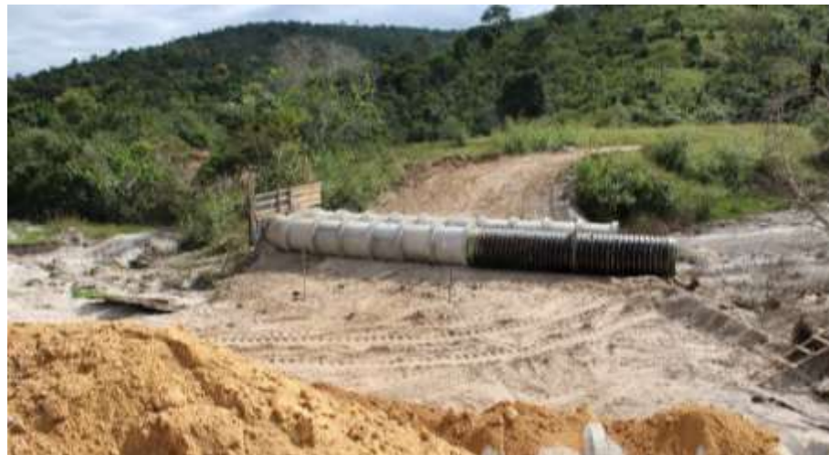
MANILHAS DOS DRENOS
